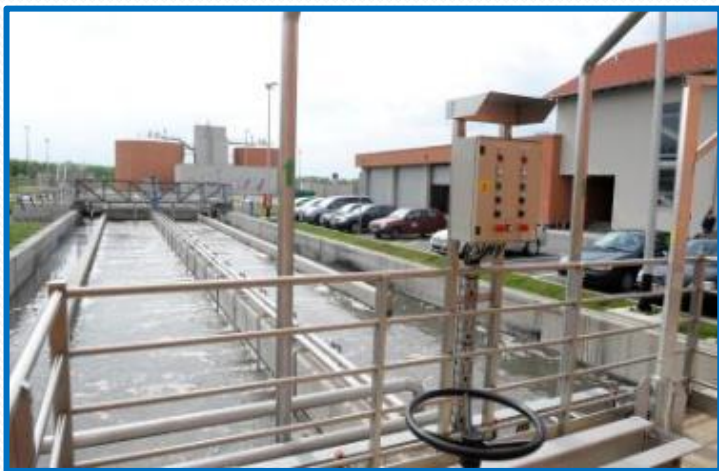
Impianto di trattamento delle acque reflue in Croazia, finanziato con il sostegno dei fondi UE
